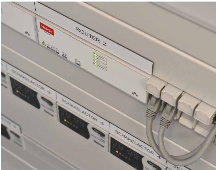
Vanuit een centrale kast wordt met behulp van DALI-routers de verlichting over de volledige site geregeld.
