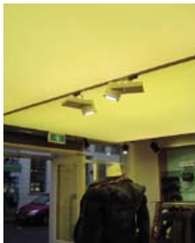
Fig. 5.5 Toepassing van verschillende typen lichtdoorlatende plafonds: fluorescentielampen boven glaspanelen (links) en fluorescentielampen boven spanplafond (rechts)
